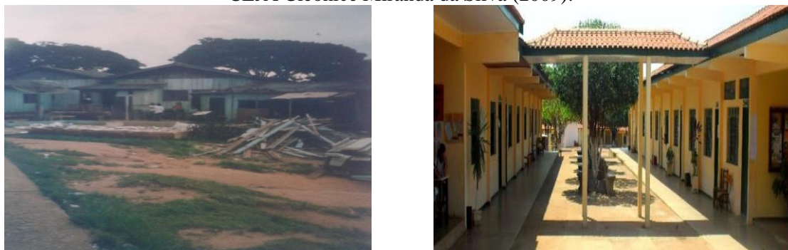
Figura 18 - E.E. Cleonice Miranda da Silva (2002) em demolição para construção de salas novas. CEJA Cleonice Miranda da Silva (2009).
